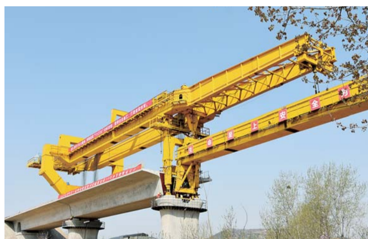
近日，二公司鲁南高铁项目顺利完成首架方桥第100箱梁架设任务。该项目共承建5处高铁箱梁支墩梁特大桥，全长累长15.8公里，需架设箱梁481根，其中首架方桥293根。袁凯峰 曹耀温 摄影报道
